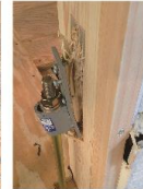
ホールダウン金物の損傷
